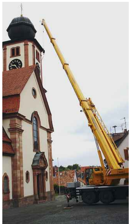
Ein turmhoher Kran hat die neue Glockenaufhängung in den Kirchturm von St. Luzia geschafft. Foto: Lothar Rollmann
